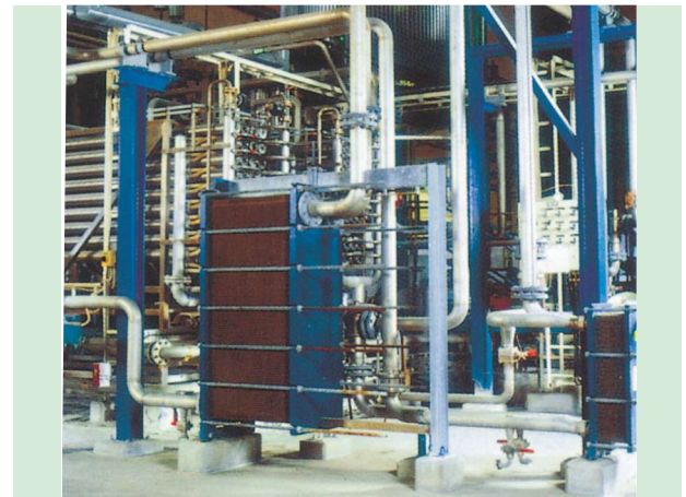
製程加熱系統 Process heating
